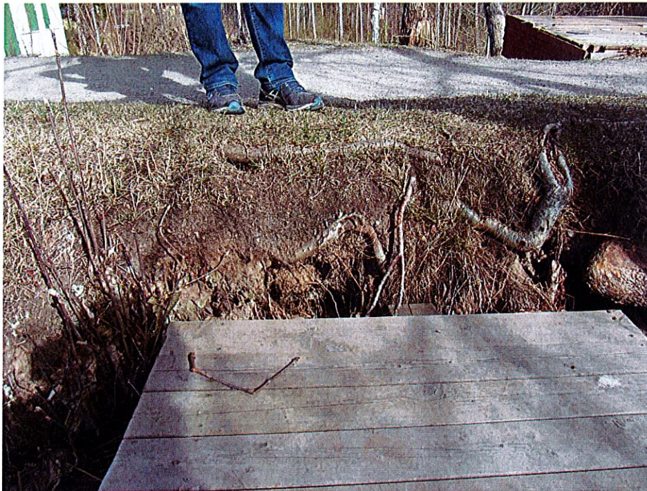
Figur 3 Omfattande erosionsskador i uppströmsslänten på dammvallen i anslutning till trädrötterna
