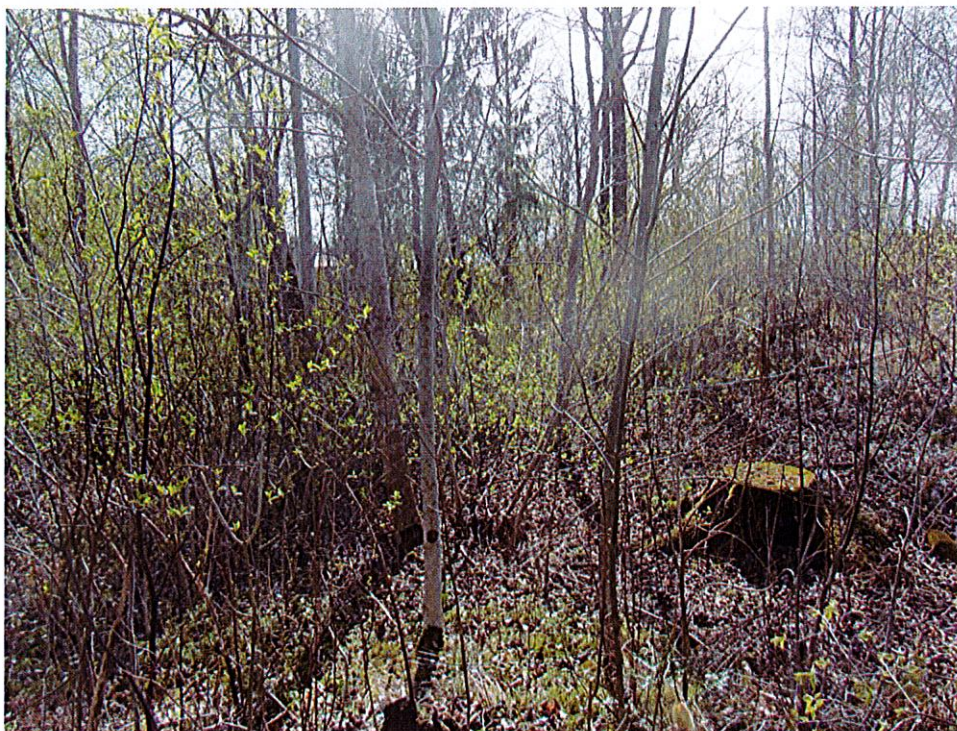
Figur 1 Växtlighet i nedströmsslänten och dammtån gör det mycket svårt att upptäcka tecken på skador i ett tidigt skede. All vegetation bör regelbundet tas bort här.
