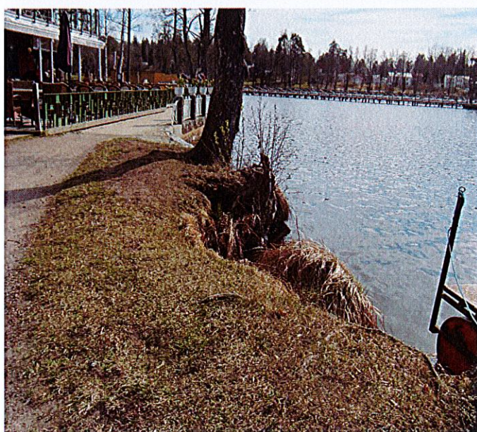
Figur 2 Omfattande erosionsskador i uppströmsslänten på dammvallen
